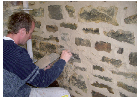
Verfugung des Mauerwerkes am Chor mit Mörteln nach histor. Rezeptur (Foto: RWS)
