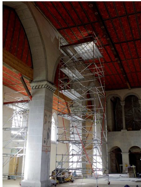
Reinigung, Sicherung und Retusche der Fassungen an Wand und Deckenflächen im Mittelschiff (Foto: RWS)
