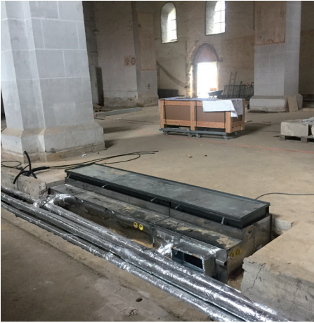
Im Boden montierte Wärmestationen, RWS
