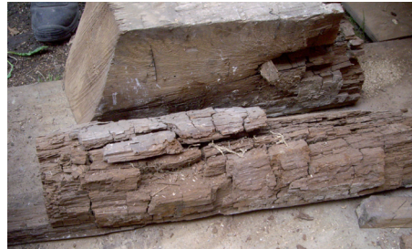
Zerstörung der Mauerschwelle durch Braunfäule, anhaftende Mycelien des Echten Hausschwammes (Foto: RWS)
