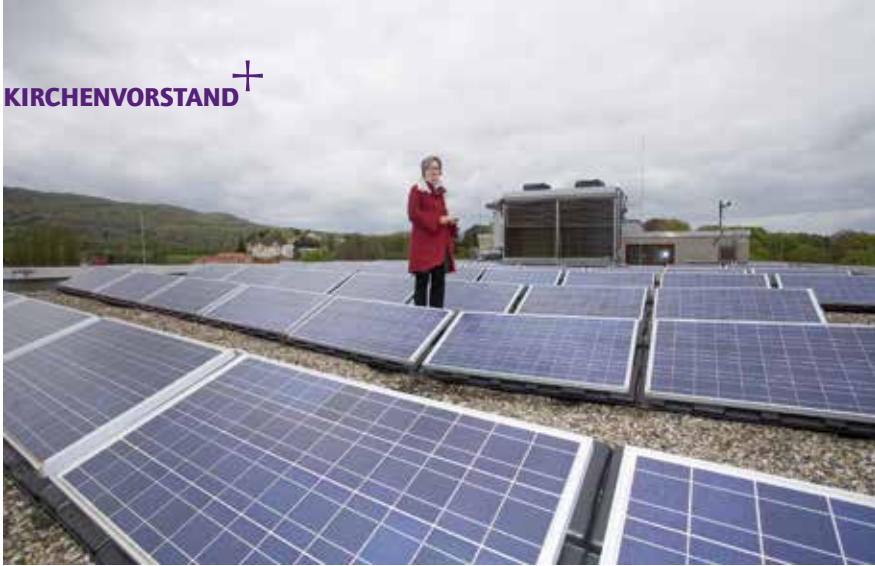
Oberlandeskirchenrätin Ute Stey zeigt die seit zehn Jahren auf dem Kasseler Haus der Kirche installierte Solaranlage
